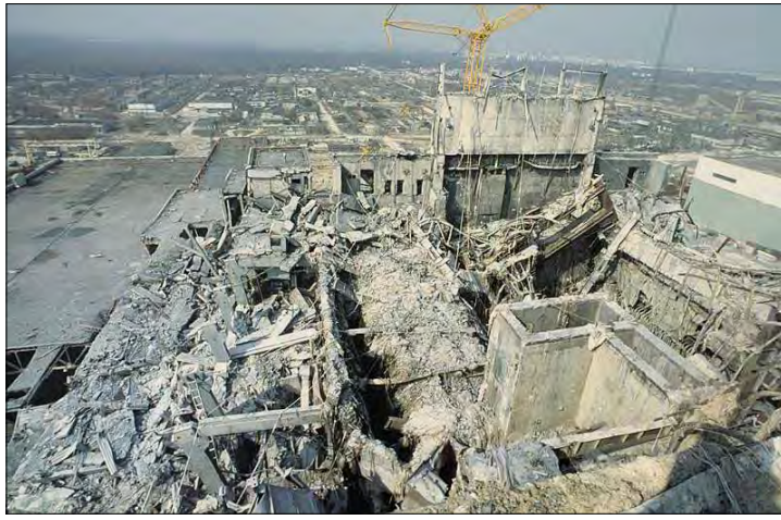
Залишки 4-го реактора, вигляд з даху сусіднього реактора.
