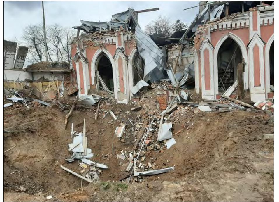
Зруйнована бібліотека в Чернігові.
